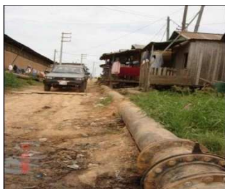
Foto N° 02 Línea de Impulsión – Captación Robalino a PTA
