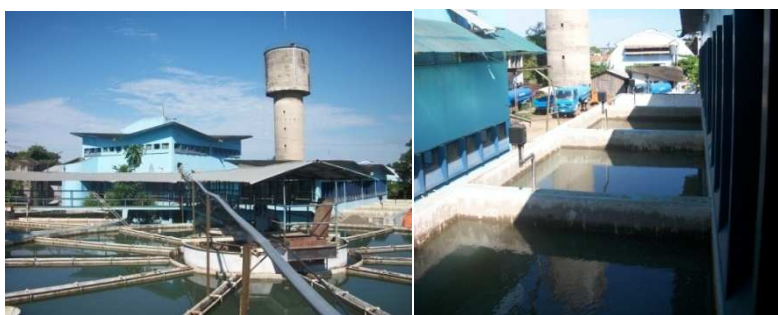
Foto N° 03: Descantador. Foto N° 04: Filtros
